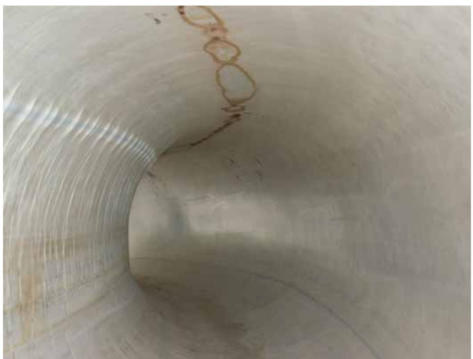
Bild 4: Unwesentliche Faltenbildung im Schlauchliner im Bogenbereich
