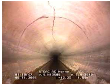
Bild 3: Längs- und Querrisse im Betonkanal, DN 550
