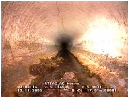
Bild 2: Verfestigte Ablagerungen und Scheitellängs-riss im Betonkanal, DN 550
